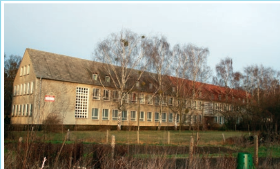
Leerstehender ehemaliger Schulkomplex in Wartenburg, heute in privater Eigentümerschaft. (Foto: W. Bock)
